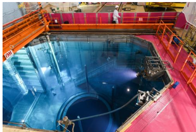
Intérieur du bâtiment réacteur n°1 de la centrale nucléaire du Tricastin. © Philippe Desmazes/AFP
