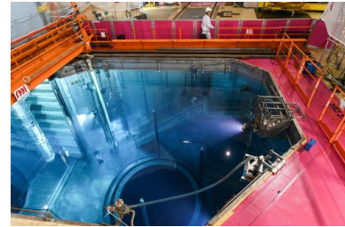
Intérieur du bâtiment réacteur n°1 de la centrale nucléaire du Tricastin, le 27 juin 2019. © Philippe Desmazes/AFP
